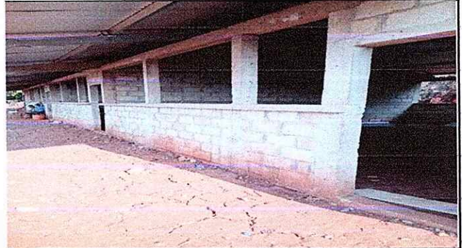
FOTO 2: En el corredor frente de la escuela se observa claramente que si hay necesidad de poner piso.
